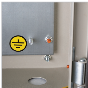
Шпилька заземления на монтажной панели.
